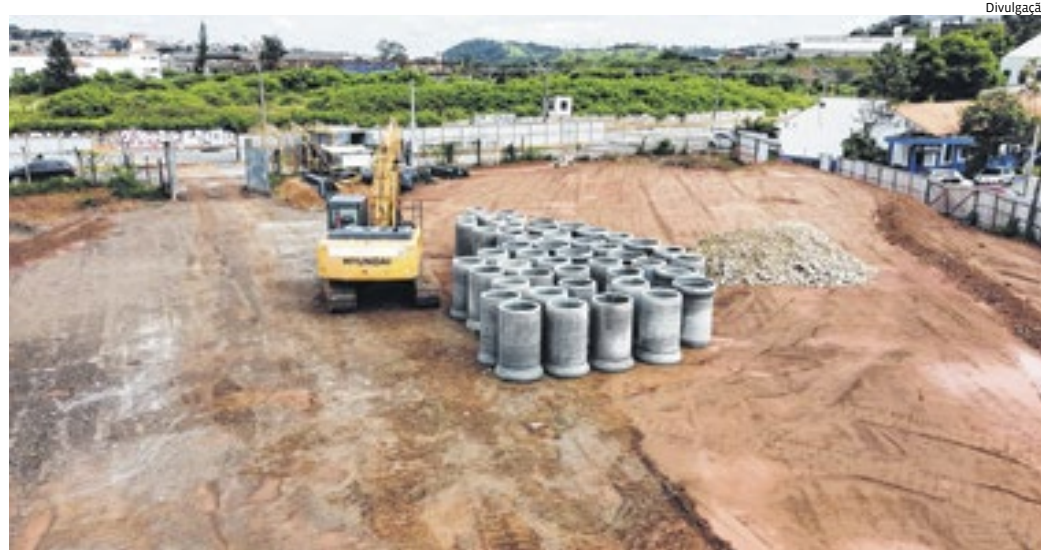
Após a terraplanagem, o sistema de drenagem será a próxima etapa para a construção do novo prédio
