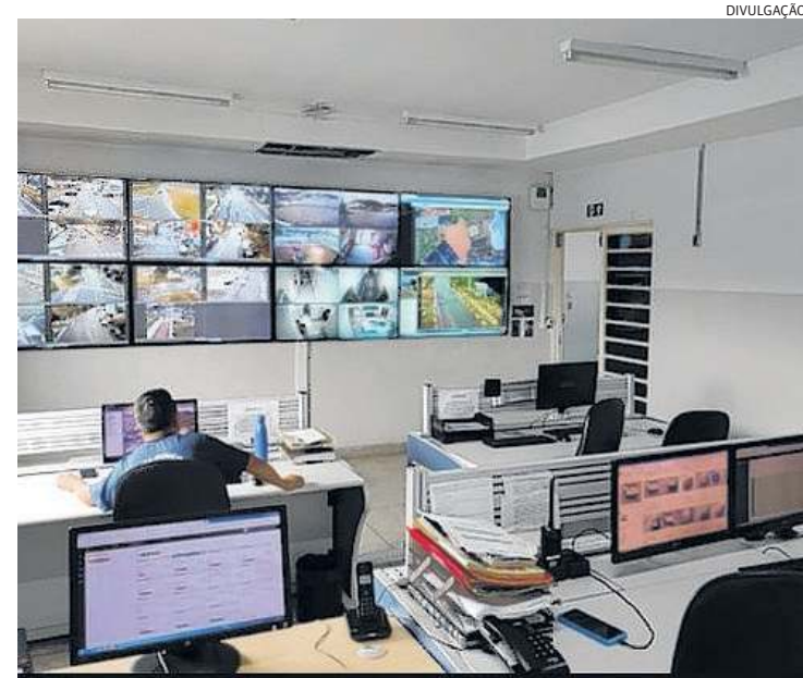
Foram instaladas câmeras dotadas de rastreamento pelo sistema OCR
